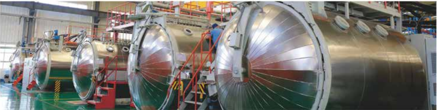
油浸式变压器干燥槽及环氧树脂真空浇注槽
